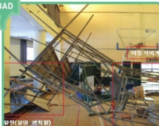
지지틀(아우트리게) 미설치로 넘어짐 재해 발생
